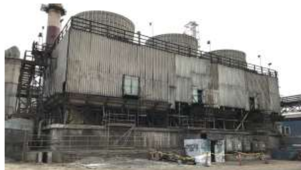
Fig. 2 - Torre de enfriamiento
