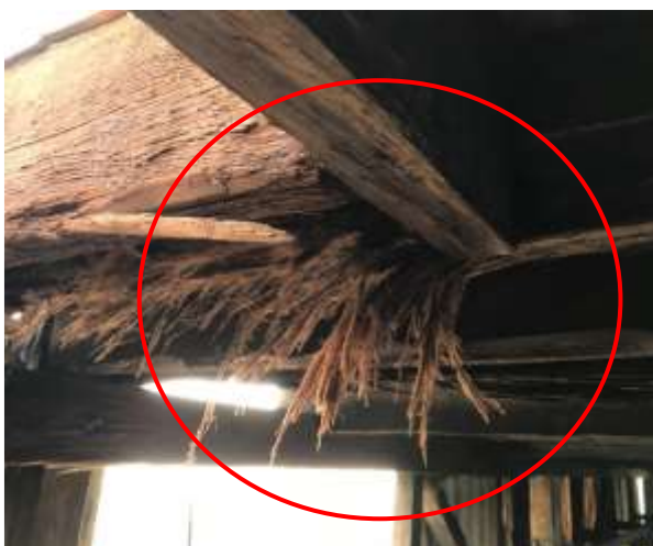
Fig. 5 - Pérdida de sección en vigas de soporte de equipos
