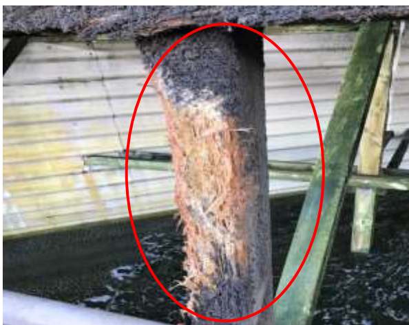
Fig. 7 - Pérdida de sección en columnas perimetrales
