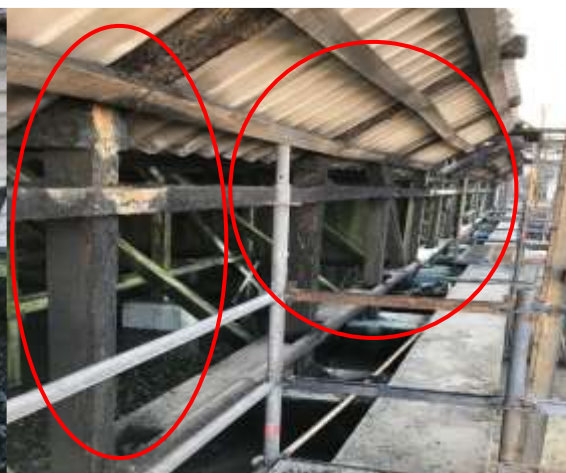
Fig. 8 - Daño crítico en columnas, vigas y puntales
