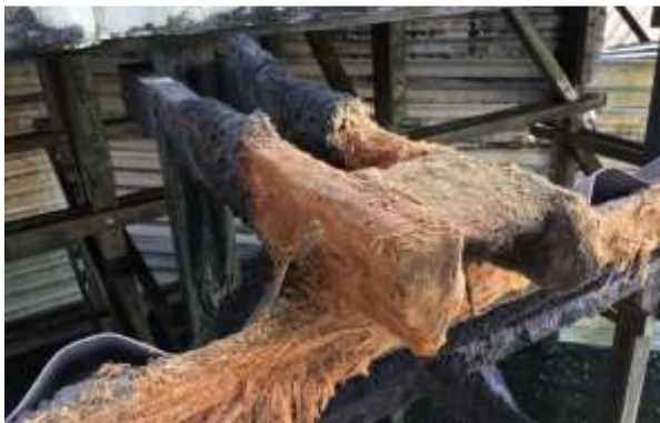
Fig. 3 - degradación en elementos perimetrales
