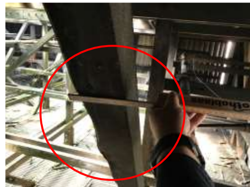
Fig. 4 - Pérdida de sección de arriostramientos
