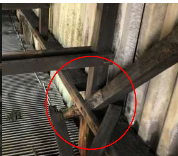
Fig. 6 - Corrosión y debilitamiento de uniones
